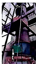
◎DA008 1#水泥库排放口 8#
