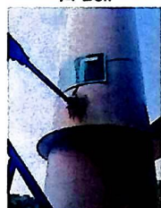
◎34DA035 3#角材反击破 排气口 34#
